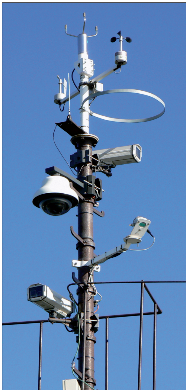
Obr. 8 Umístění webových kamer na Lysé hoře, foto Pavel Lipina.
