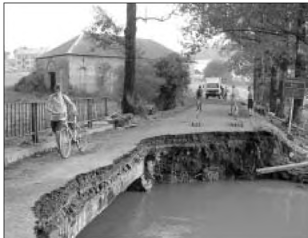
Obr. 2 Zničená silnice povodní na hranici okresů Žďár nad Sázavou a Blansko pod obcí Louka. Foto J. Svoboda.
